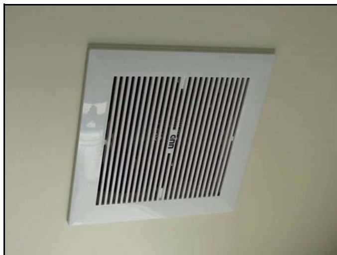
Bathroom Exhaust Fan
